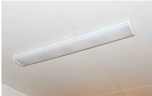
Kuva: Luja-levyt ja loisteputkivalaisin.
